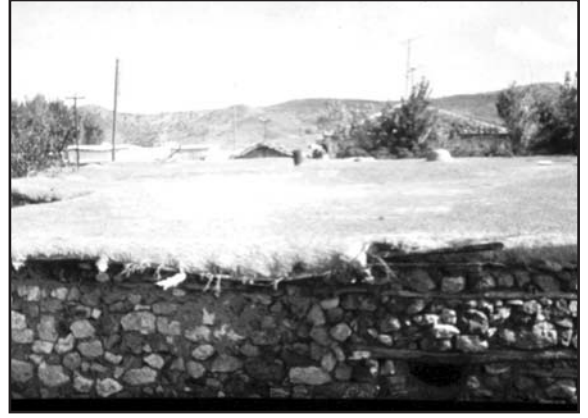
Resim 9: İçinde asbest bulunan toprağın izolasyon, sıcak ve soğuktan korunmak için çatıya serilmesi.
